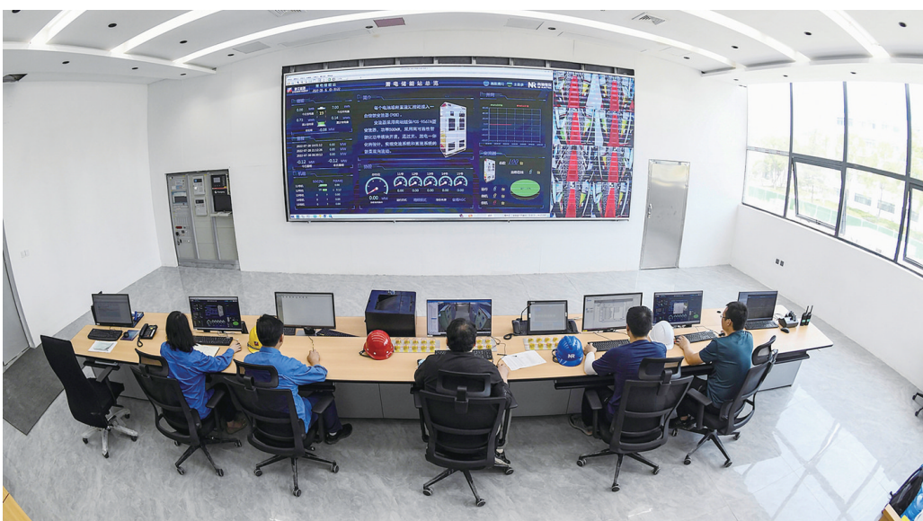
运行人员监视储能设备控制大屏。新华社发
